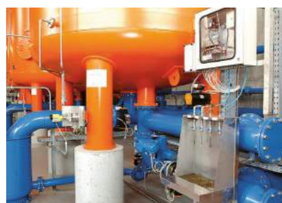
Das Grundwasser wird aus grundwasserführenden Schichten zwischen 50 und 100m gefördert und anschließend in den Wasserwerken Mühlenscharn und Pinnow aufbereitet
