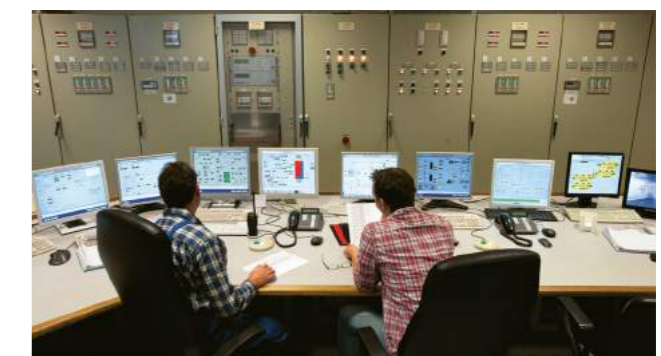
Mitarbeiter im Kraftwerk Schwerin Süd koordinieren die Strom- und Wärme-erzeugung und überwachen den Betrieb des Fernwärmenetzes
