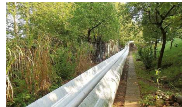
Oberstes Ziel ist es, die Stadt Schwerin zu jeder Tageszeit sicher mit Fernwärme zu versorgen
