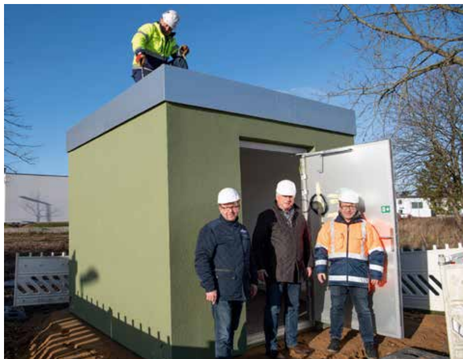
Mario Montag (v.l.) von den Stadtwerken Schwerin, Geschäftsführer Dr. Josef Wolf und Michael Manthe von der ausführenden Firma C&S Breitband GmbH bei der Errichtung des PoP-Standorts in der Güstrower Straße
