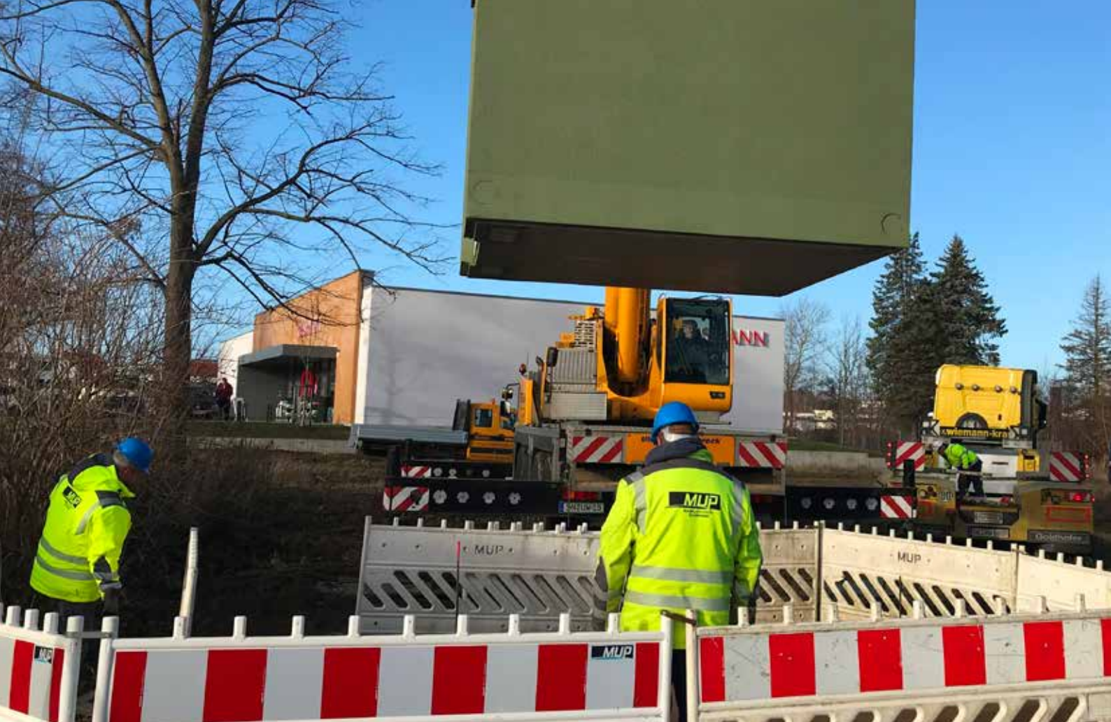
Am 4. Dezember wurde an der Güstrower Straße der 29. von insgesamt 51 PoP-Standorten für den Ausbau des Glasfasernetzes in Schwerin aufgestellt
